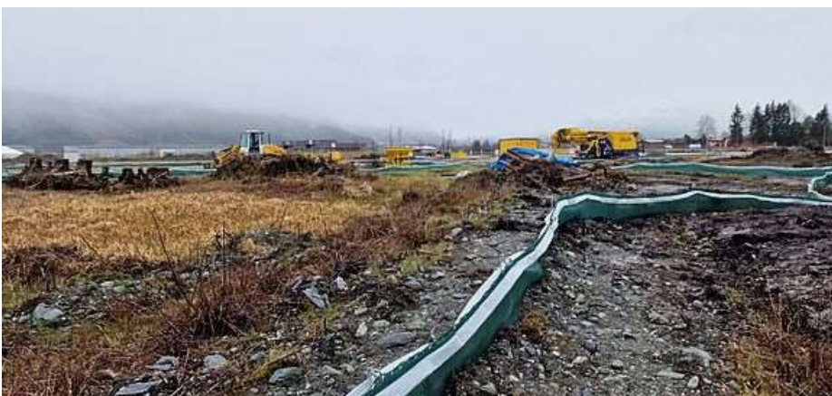
Arbeiten im als Bauland gewidmeten Moor samt Überschüttung wertvoller Feuchtlebensräume am ehemaligen Flugplatz Zell am See, Foto: LUA
